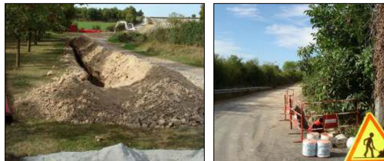
Photo 4 : Exemple de travaux pour le raccordement au réseau public de distribution (Source : VALOREM)
