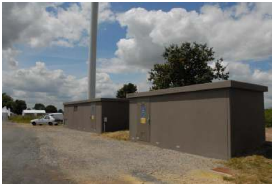
Photo 9 : Exemple de poste de livraison
